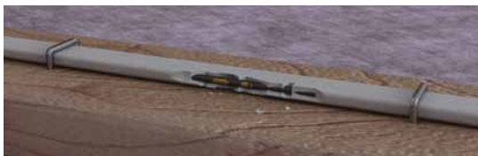
Les rongeurs peuvent endommager la gaine des conducteurs
