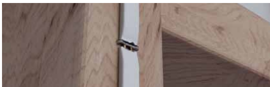
Une agrafe peut endommager l'isolant du câble (non-conforme)
